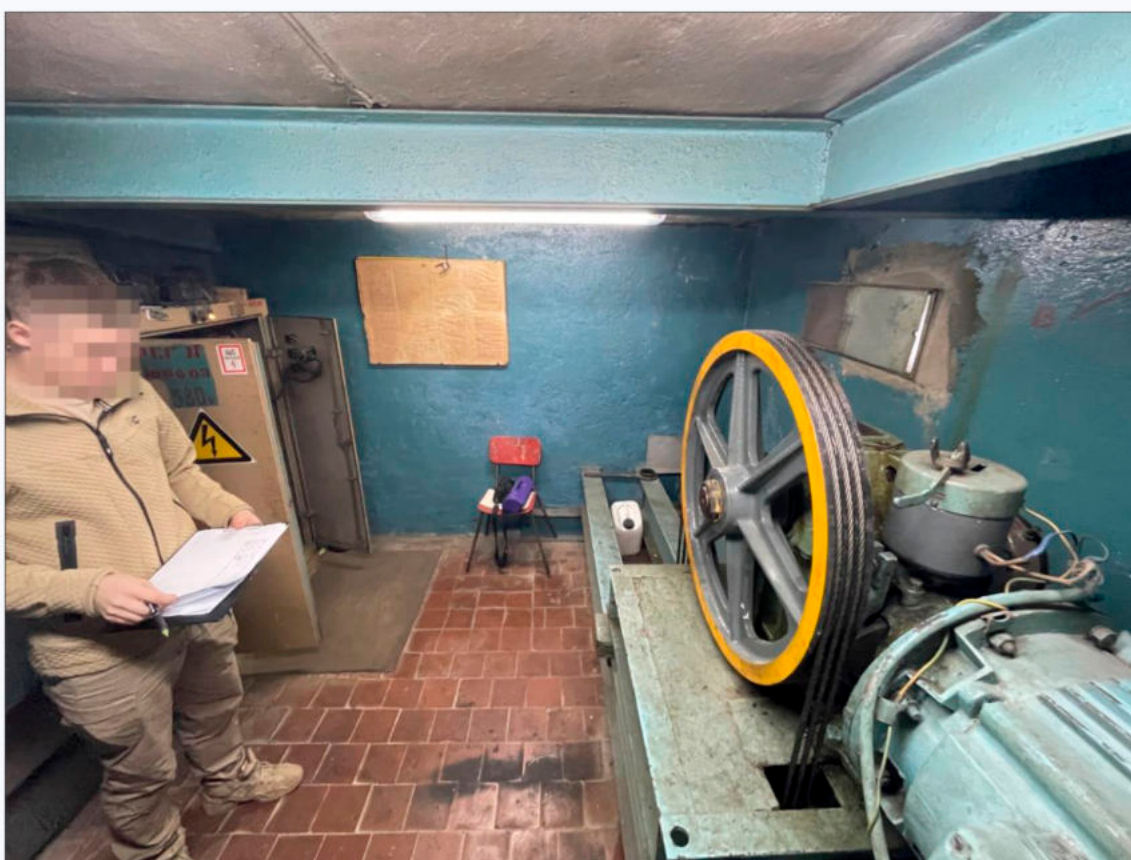
Фото 4. Общий вид машинного помещения.
