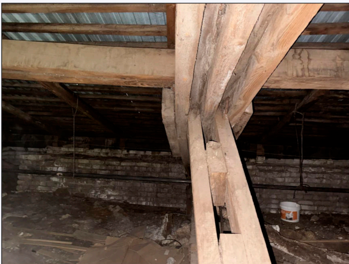
Фото 30. Локальный вид аварийного участка стропильной системы
