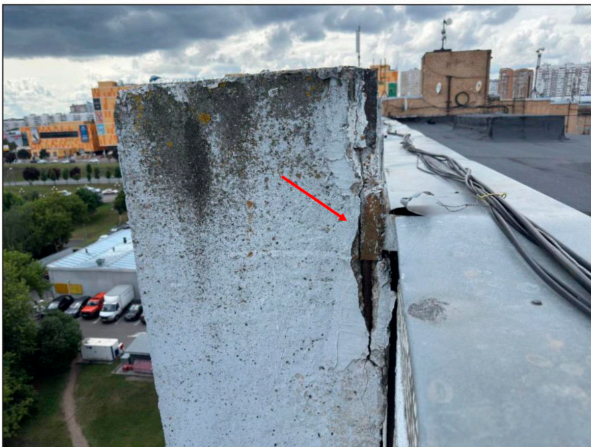
Фото 18. Локальный вид аварийного участка
