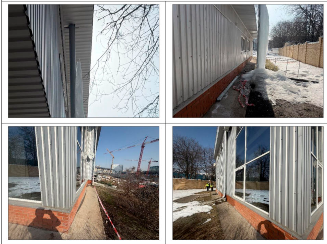
Табл.26. Дефекты, повреждения и нарушения конструкций кровли элементов системы для предотвращения дальнейшего развития дефектов.
