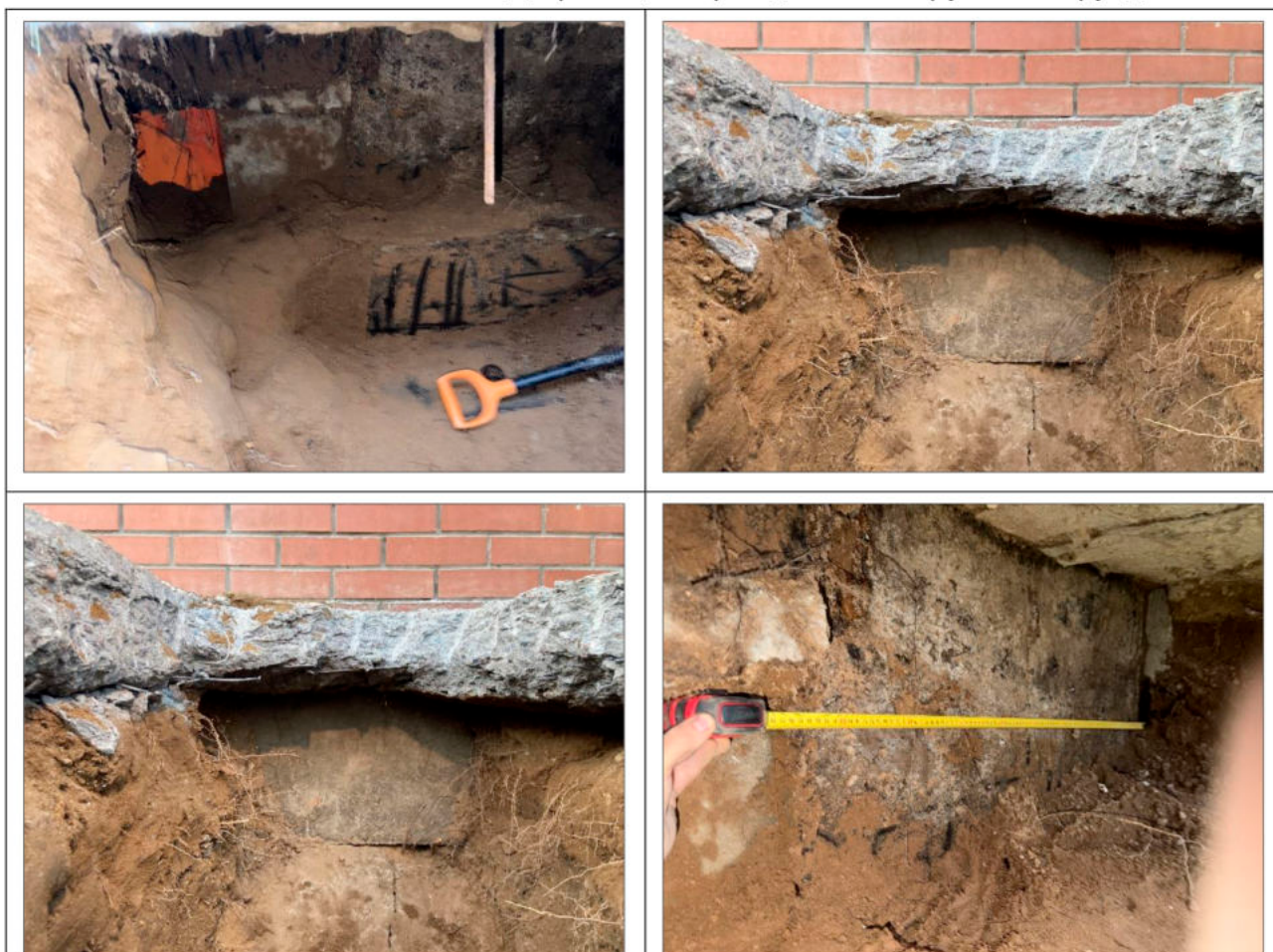
Табл.11. Дефекты, повреждения и нарушения фундаментов
