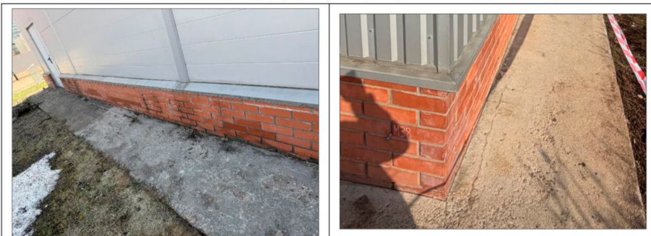
Табл.11. Дефекты, повреждения и нарушения фундаментов
